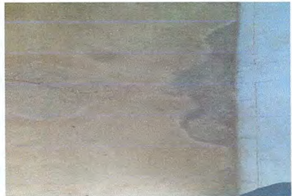
Modulo 1 :Piso deteriorado
