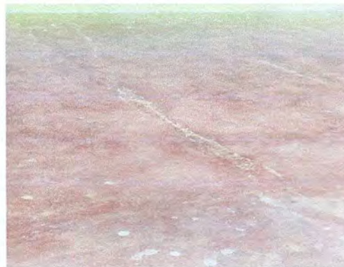
Modulo 5 :Piso deteriorado con grietas
