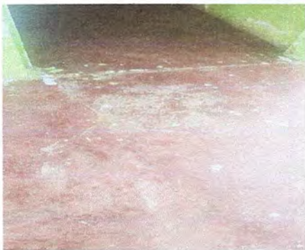
Modulo 2 :Piso deteriorado con grietas
