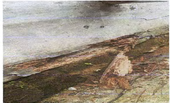
Foto 2: Pared de tabla en mal estado
