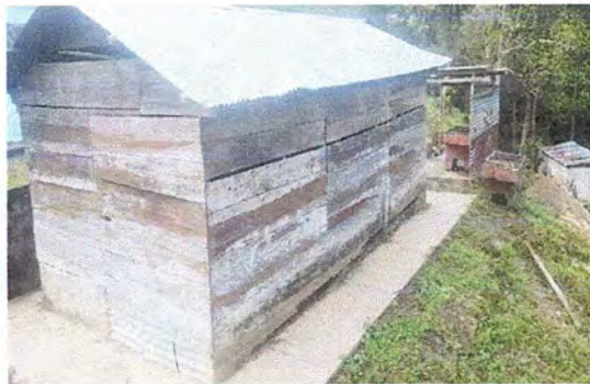
Foto 3: Cocina en mal estado sin ventilación
